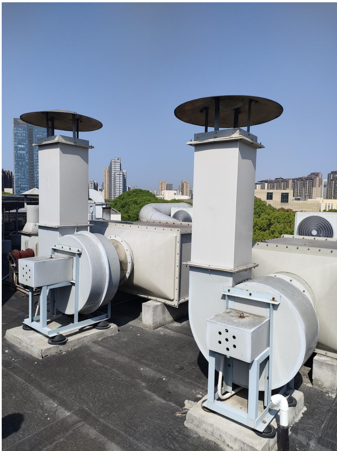
废气处理设施
