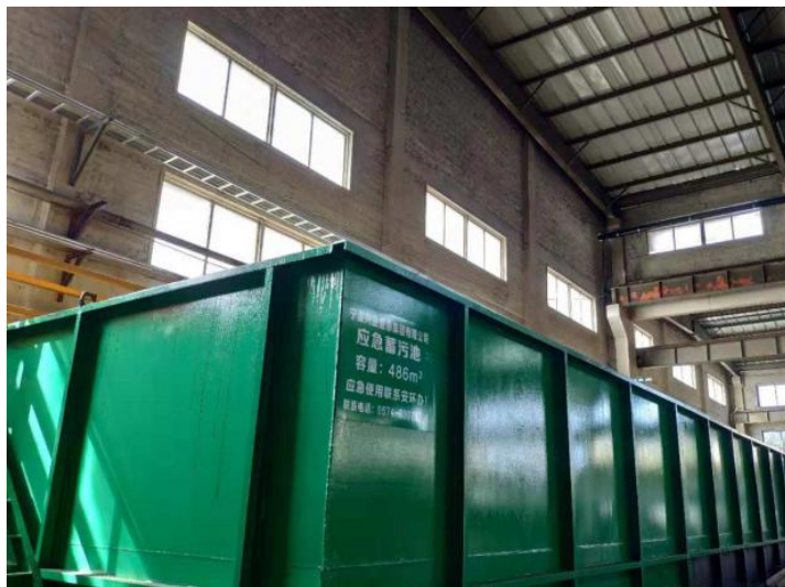
图 4.2-1 应急事故池现场图
