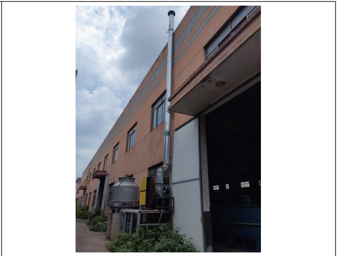
废气处理设施（远景）
