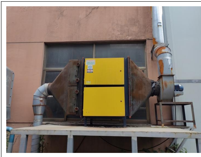
废气处理设施
