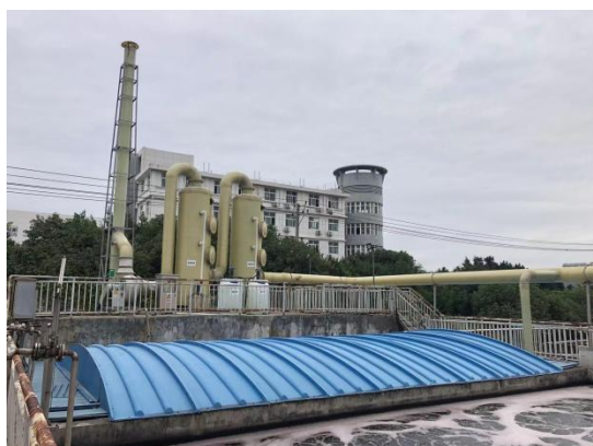
一期污水站处理设施
