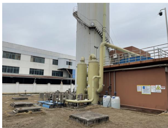
二期污水站处理设施
