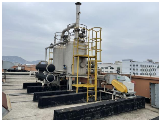
酸酐制备（异丙醚）废气处理设施
