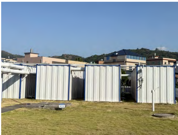
一体化污水处理设施
