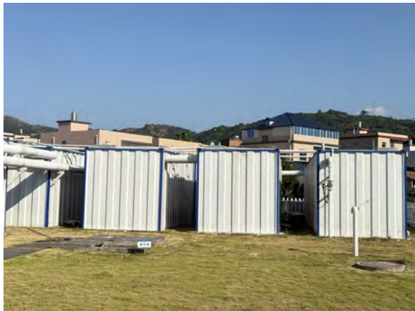
一体化处理设施
