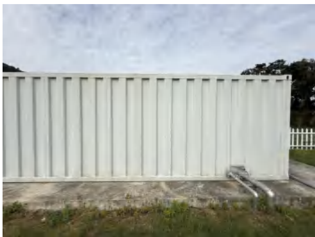
密闭污水处理设施
