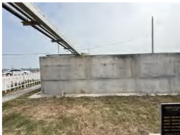
地上密闭调节池
