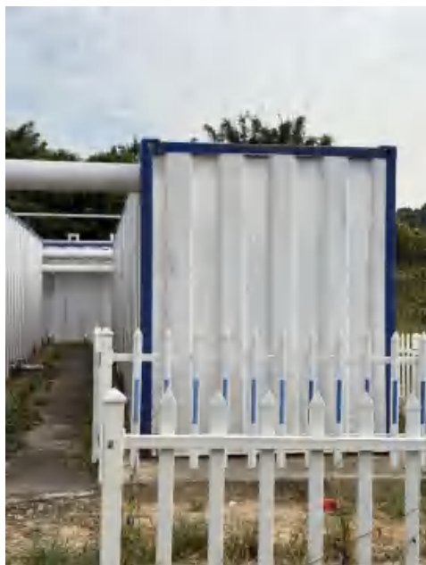
一体化处理设施
