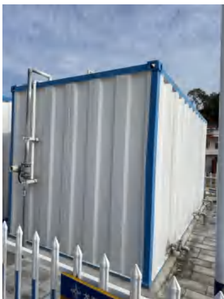
一体化污水处理设施
