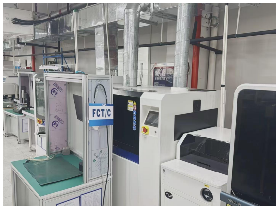
UV 固化、干燥、涂覆设备现场照片
